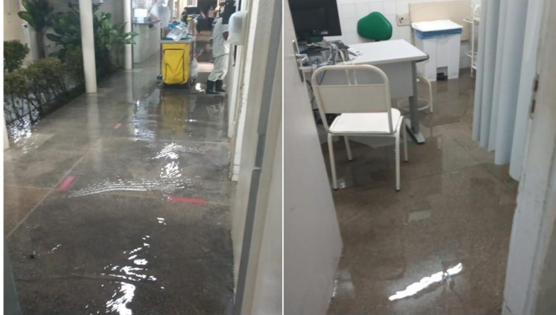
Figura 2 - Maternidade do Satélite em Teresina alagada por fortes chuvas - 2022
